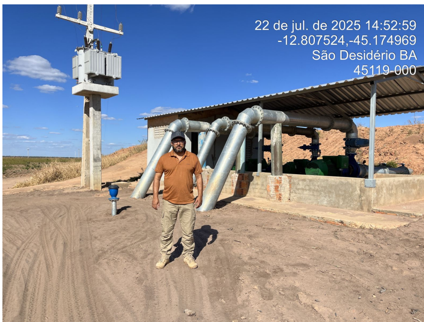
Imagem estação de bombeamento, Faz. Rio Grande
