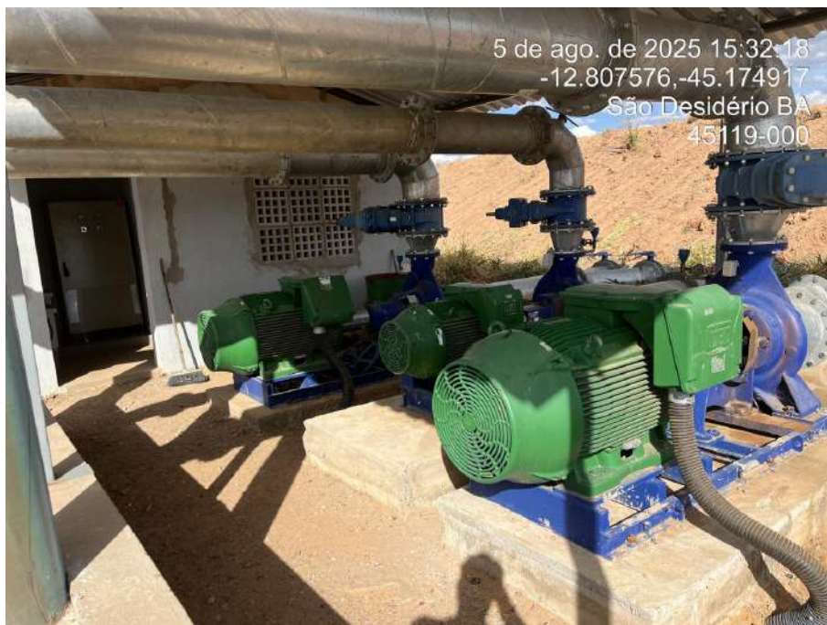
Imagem estação de captação bombeamento para pivôs, Faz. Rio Grande
